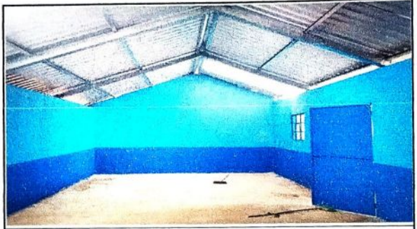
Foto 4 Así luce la nueva estructura de metal que se le coloco a este modulo, Modulo 2
