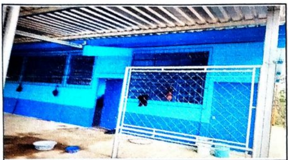
Foto 3: Se observa el cambio que se ha hecho despues del lijado y pintura en la estructura. Modulo 1
