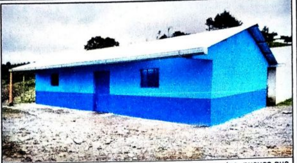
Foto 2: De esta forma se han quedado las laminas y capotes nuevos que estaban en mal estado. Modulo 2.
